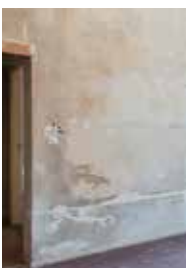
Supporti disuniformemente assorbenti
