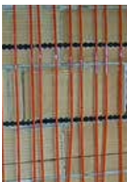
Riscaldamento a parete/soffitto
