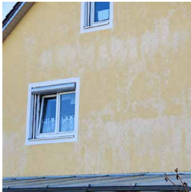
Efflorescenze sulla facciata
